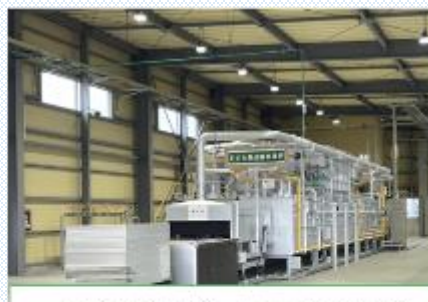
太陽光パネルリサイクル
